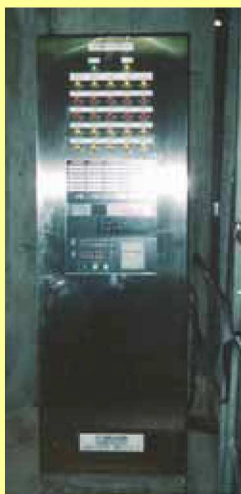
システム制御盤
