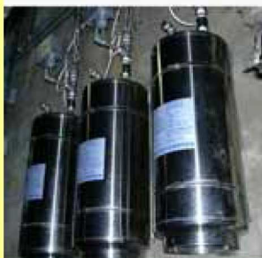
消火剤容器および起動装置
