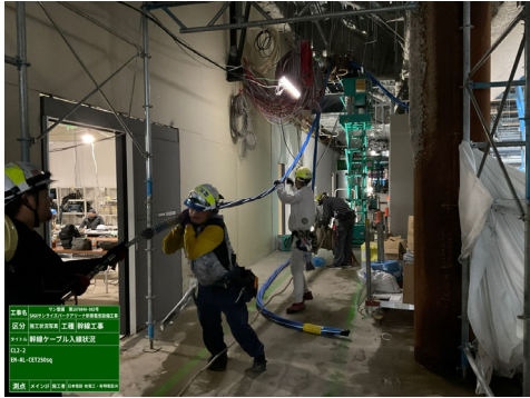
日本電設工業提供
