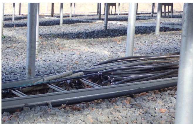
<切断された銅導体ケーブル>
