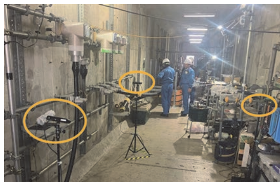
図9 現場でのカメラの設置状況
