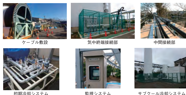
図3 戸塚プロジェクトの各設備
