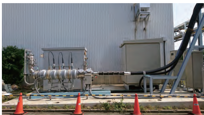
図 11 三相同軸超電導ケーブル終端接続部
