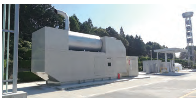
図4 非常用発電機・燃料備蓄設備更新
