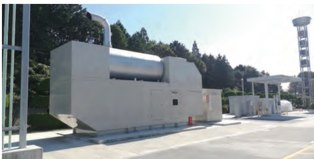
図4 非常用発電機・燃料備蓄設備更新
