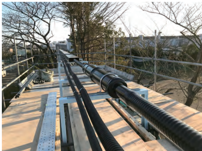
図 10 三相同軸超電導ケーブル中間接続部
