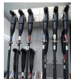
図5 6 kV スイッチギア
