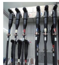
図5 6 kV スイッチギア
