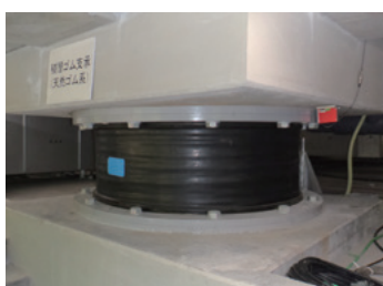
図 2 減災館に設置された積層ゴムアイソレータ
