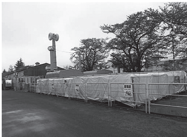
図8 長期課通電試験線路全体
