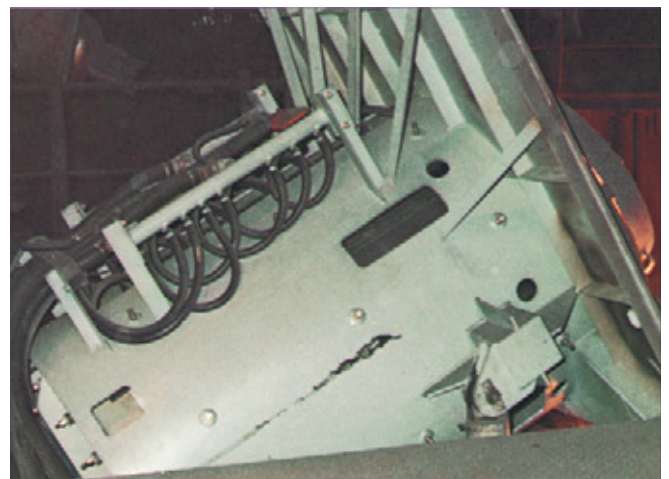
誘導溶解炉での使用状況
