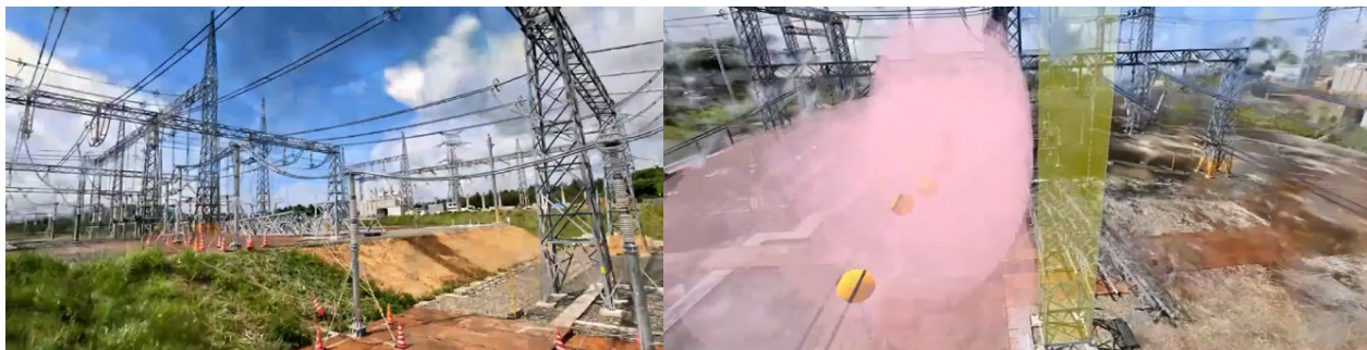
【3D データ化し、離隔を可視化した超高压電気所の画像】
