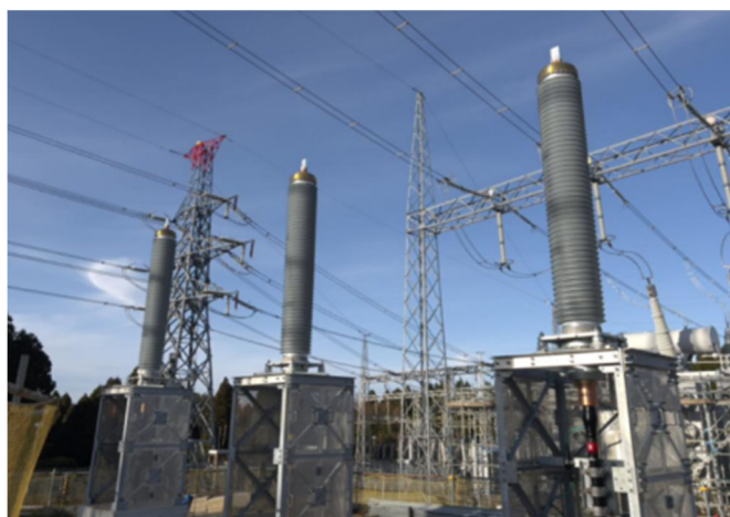
写真: 加賀変電所に建設した「プラグインタイプ 超高压 275kV スマート気中終端接続部」
