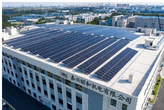
太陽光発電設備を導入した JSIP の工場
