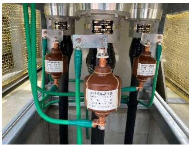
写真1 (コンパクトガス中終端接続部)
