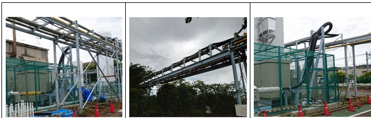
図7 敷設した超電導ケーブル 専用ラックへの立ち上がり水平部分
