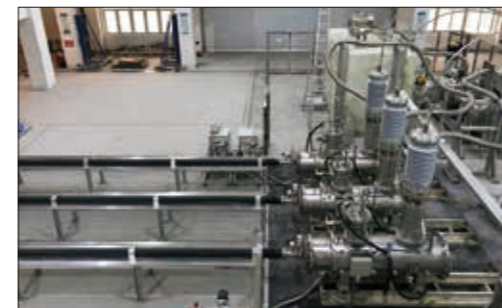
天津で稼働中の超電導ケーブルと終端
