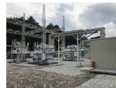
民間プラントの変電設備
