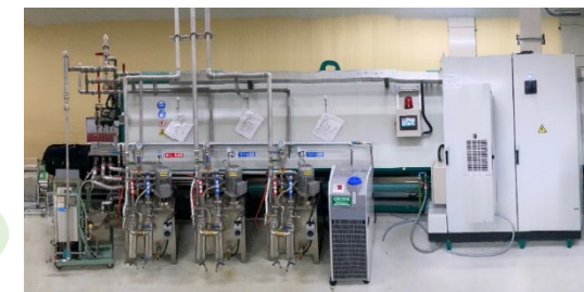
巻線製造ラインへの省エネ設備導入 三重事業所
