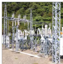
発電所・変電所
