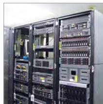
ヘッドエンド・サーバールーム
