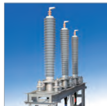
電力送配電設備
