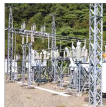
発電所・変電所
