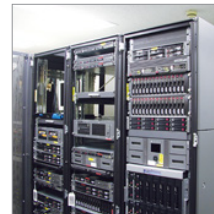
サーバールーム
