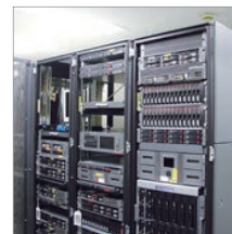
サーバールーム
