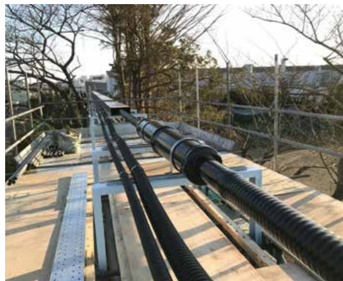
三相同軸超電導ケーブルシステム実証実験
