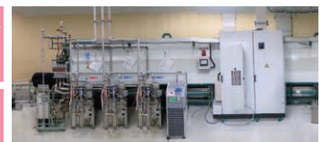
巻線製造ラインへの省エネ設備導入 三重事業所
