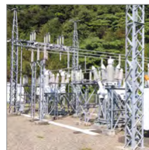
発電所・変電所
