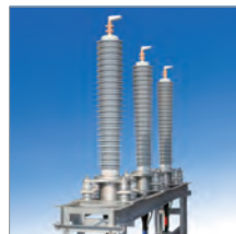
電力送配電設備
